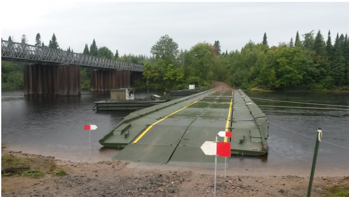
Le 51 e Escadron de campagne du 5 RGC a complété un pont flottant moyen sur la rivière Jacques Cartier pouvant supporter une véhicule de 70 tonnes et moins.
