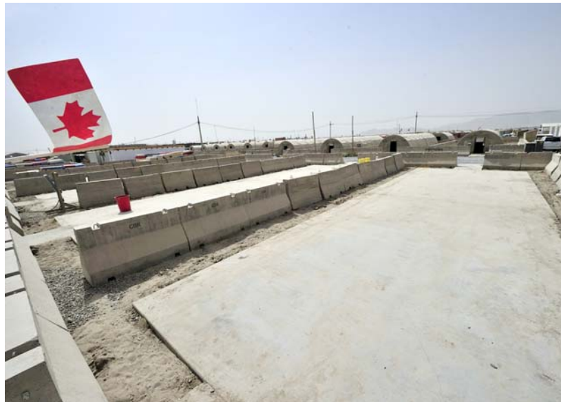
Le foyer de centaines de soldats au cours de plus de 10 rotations de combat de la Force opérationnelle interarmées en Afghanistan, CANADA 5 est maintenant démonté par le Régiment du Génie de la FOTM
