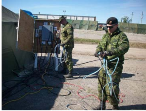
Le Technicien en distribution électrique, le Cpl Martin Hamel, travaille à un réseau de distribution électrique pour la cuisine du camp
