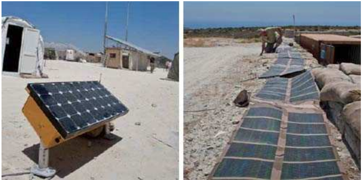
Les systèmes éoliens et solaires ont été au cœur de la démonstration. Tous les systèmes ont été branchés sur la grille EBOA et vérifiés quant à leur efficacité énergétique, la puissance utile et la compatibilité en même temps que d'autres solutions. Photos par Pete Gowing.
