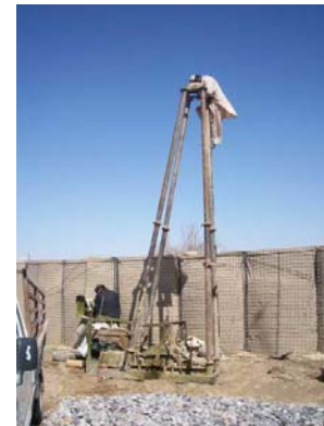
Photo par le Sgt Cripps Des membres de l'EAG supervisent des entrepreneurs locaux installant un dispositif de creusage de puits à l'avant-poste de combat Zangabad.
