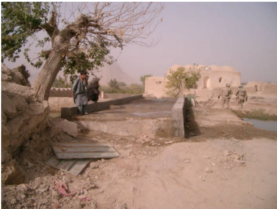
Le pont, dont la construction est presque terminée, situé à environ 20 mètres à droite de la passerelle improvisée.
