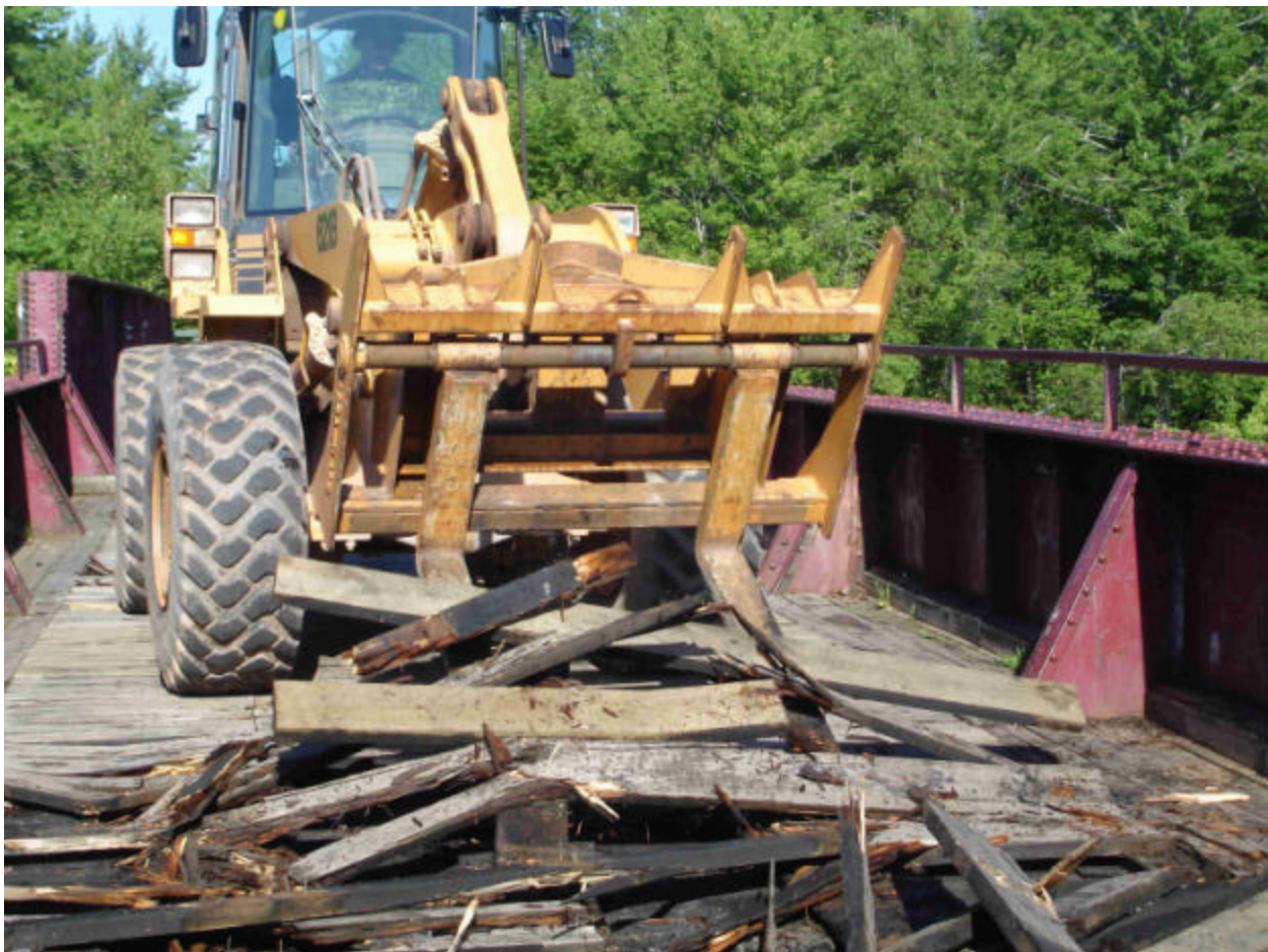
Au moyen d'équipement lourd, on arrache le tablier et les longrines endommagés par le feu pour les remplacer. (photo : Sap J. Strange)
